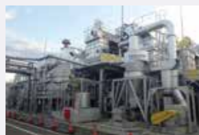
バイオマスボイラ （群馬工場）
