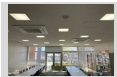
室内機設置工事。ビルトイン機器から効率の良い天井カセットへ変更。フィルター交換もたやすくなりました。
