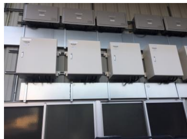
工場内の機械電気容量に合わせて 三相PCS 10KW:22台 単相PCS 5.5KW 6台を設置
