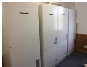
事務所棟は蓄電池を導入し平常時はピーク電力の抑制に、停電時は機器のバックアップに使える安心。
