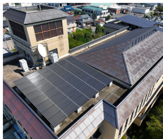
太陽光発電システム 71kW
