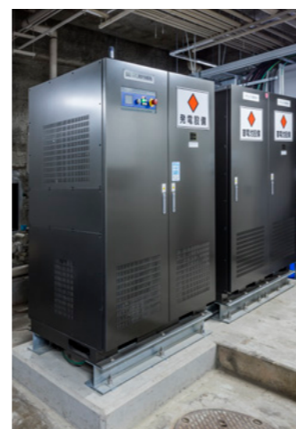
リチウムイオン蓄電システム 119kWh
