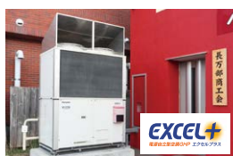
▲エクセルプラス室外機
