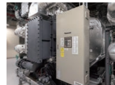
新長崎駅ビルにはパナソニックの吸収冷温水機（ナチュラルチラー）が稼働。
