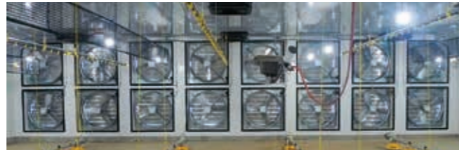
鶏舎排気側の換気扇+電動シャッター
