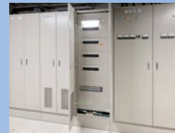
改修後の調光器盤
