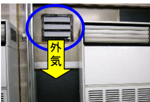
サーバー室外気取り入れ
